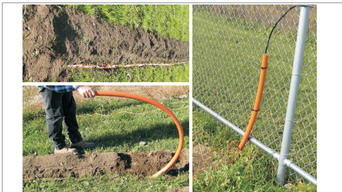
Figure 57 Solid wall conduit
